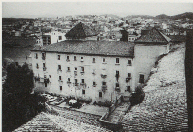
Aspecte del deteriorament de l'edifici esdevingut caserna de la guàrdia civil. (Foto J. Ferrer).
